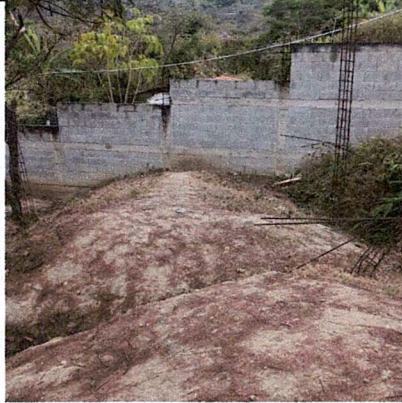
Foto 1: Área donde se contempla hacer el mejoramiento de la estructura tipo portico para cocina.
